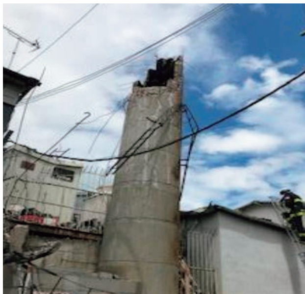
枚方市の被害状況 (枚方寝屋川消防組合消防本部提供)
